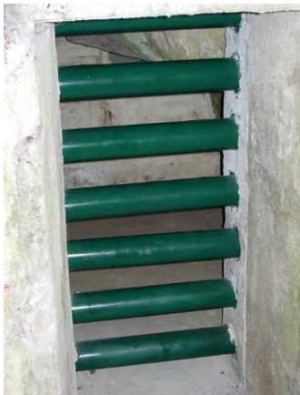
Grille de protection contre les intrusions (Photo : J. Sudraud)
