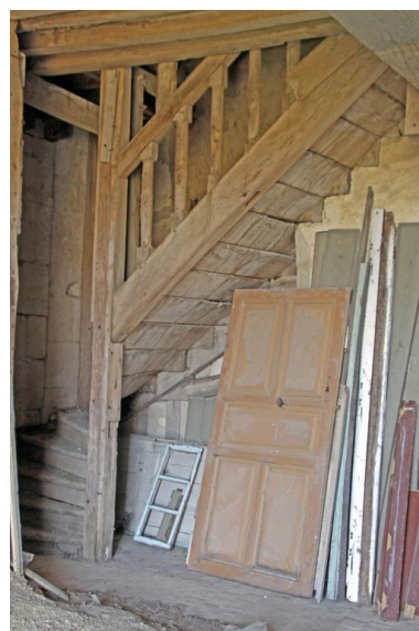
Pavillon, étage côté cour, chambre à feu : escalier menant au comble. Phot. Jean-Baptiste Darrasse IVR52_20107200417NUCA
