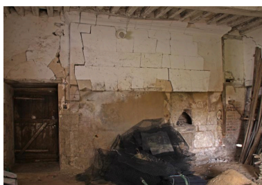
Pavillon, r-d-c côté cour : pièce à feu à cheminée double. Phot. Jean-Baptiste Darrasse IVR52_20107200429NUCA
