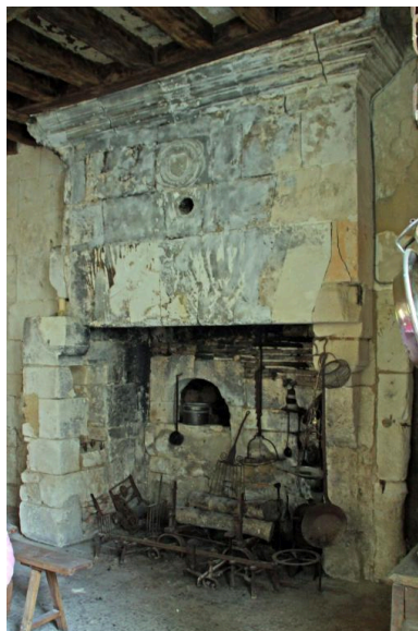
Corps central, rez-de-chaussée, pièce à feu côté cour : cheminée. Phot. Jean-Baptiste Darrasse IVR52_20107200423NUCA
