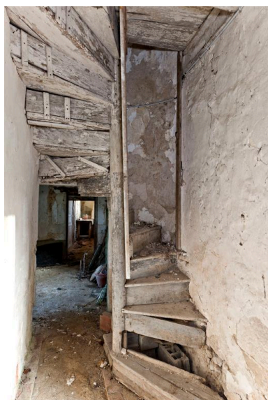
Dépendance 1, RdCh : escalier en vis, en bois, montant au comble. Phot. Yves Guillotin IVR52_20127200259NUCA
