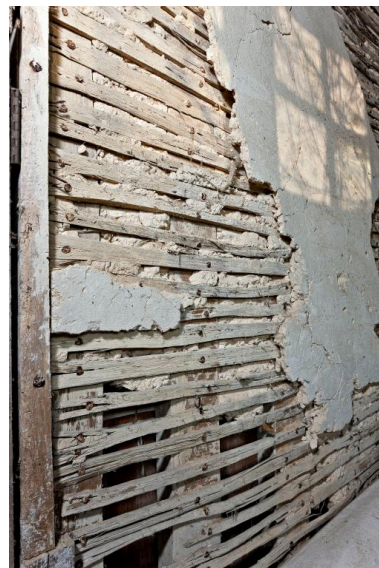
Dépendance 1, RdCh : détail d'une cloison à pan de bois en torchis sur lattis. Phot. Yves Guillotin IVR52_20127200260NUCA
